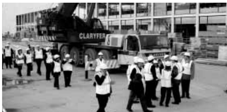
Los asistentes al Encuentro y la Ejecutiva visitan las obras de la nueva estación intermodal
